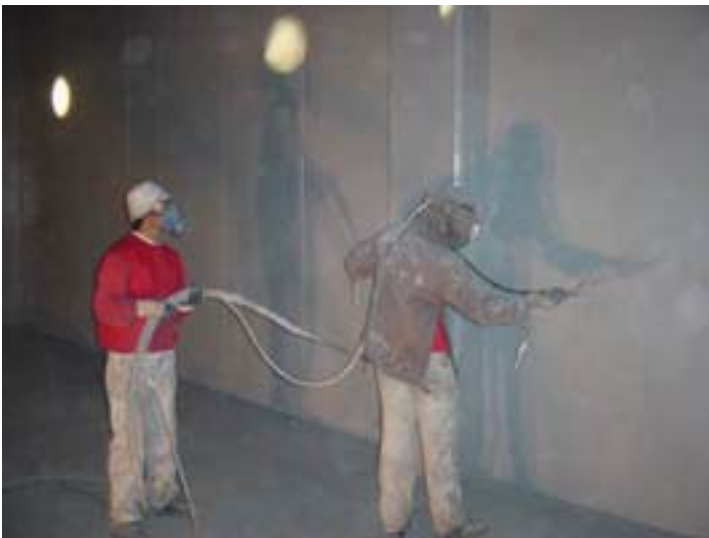
Puis une couche de 250 \mu de Bi-composant le époxydique sans solvant CHEMI-TECH UW a été passée au pistolet Airless et un équipement pompe Graco King dual et chauffant .
