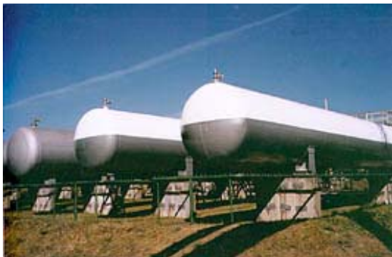
VUE DE LA BATTERIE DE TANKS
