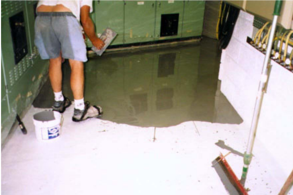
Ici une vue de l'opérateur qui commence l'application du revêtement autolissant « Floor-Tech PR »
