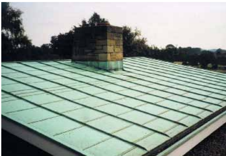
Une vue de la toiture avant traitement
