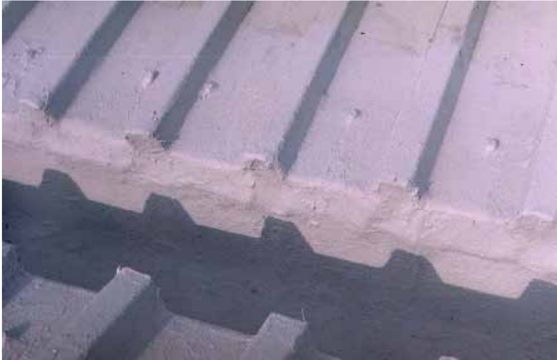
ICI ON PEUT VOIR LE DETAIL DU RACCORD D'ETANCHEITE ENTRE LES PAROIS DU CHENAU ET LA SURFACE DE LA TOITURE
