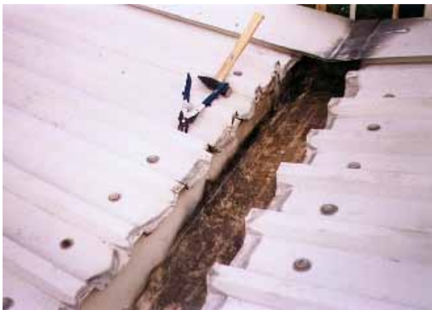
ICI UNE VUE DES CHENAUX AVANT TRAITEMENT
