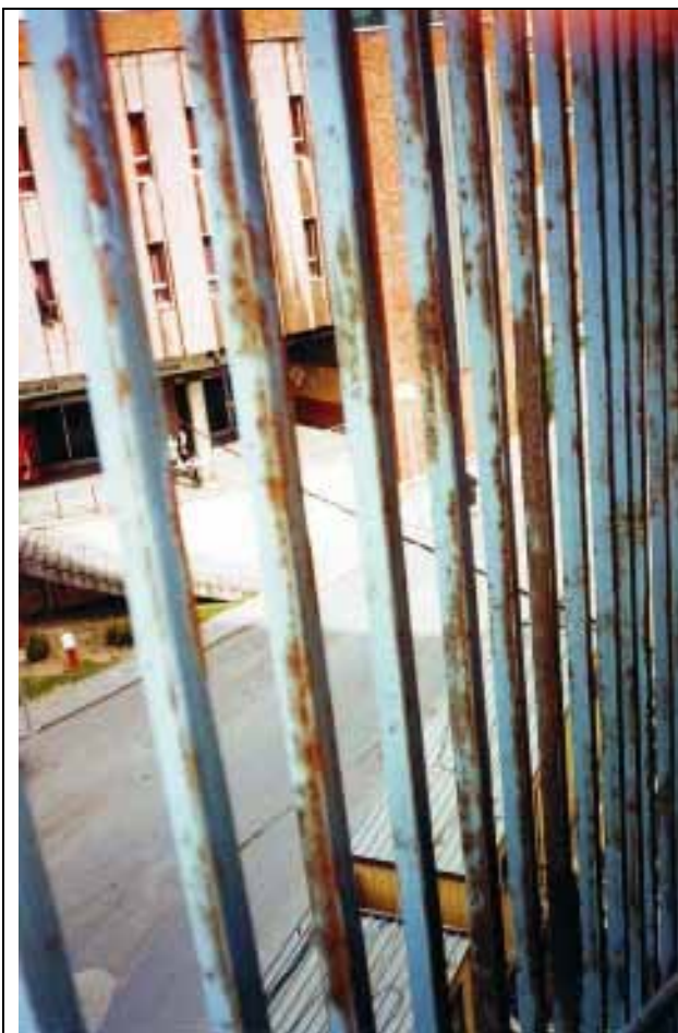
Vue des rambardes avant traitement
