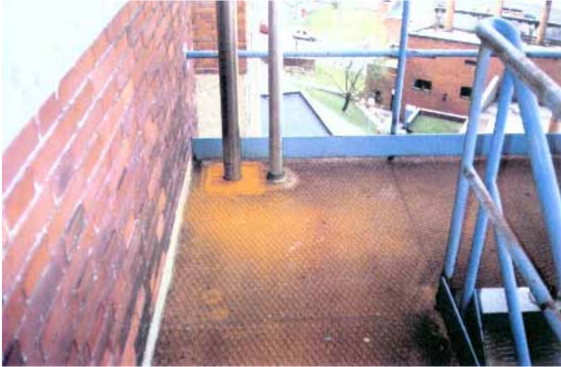
Vue du palier en tôle d'acier gaufrée montrant la corrosion avant traitement
